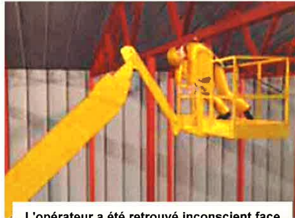
L'opérateur a été retrouvé inconscient face vers le bas avec le dos contre la structure
